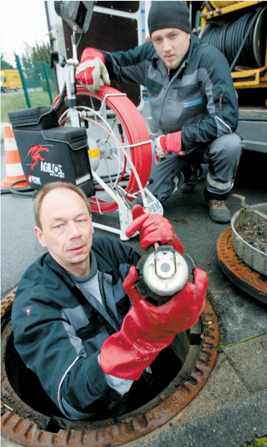
Elektronisches Auge: Oliver Niemann (vorne) und Jens Heitbreder demonstrieren in Herford, wie sie mit einer Spezialkamera die Abwasserkanäle untersuchen. FOTO: FRANK-MICHAEL KIEL-STEINKAMP
